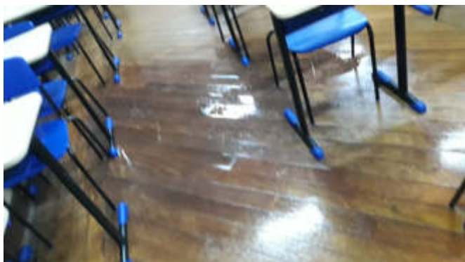
4. Goteiras em sala de aula
