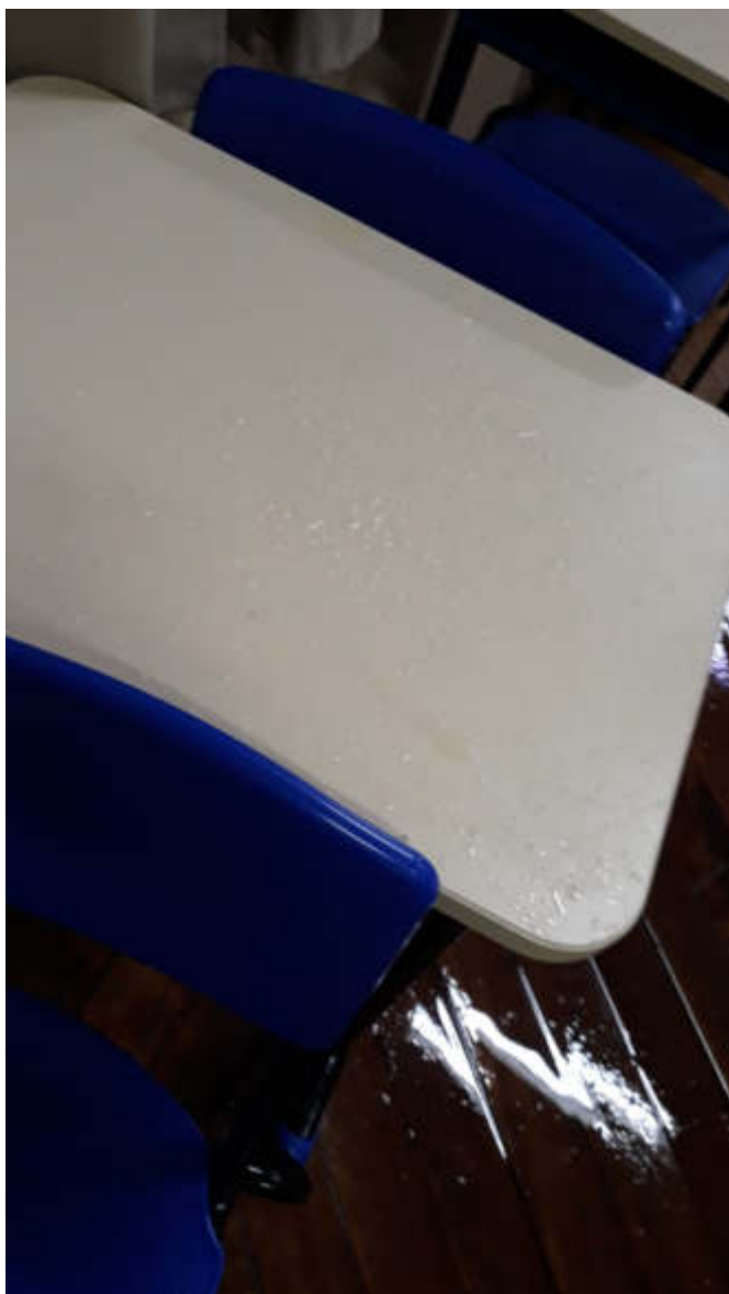
1. Goteiras em sala de aula
