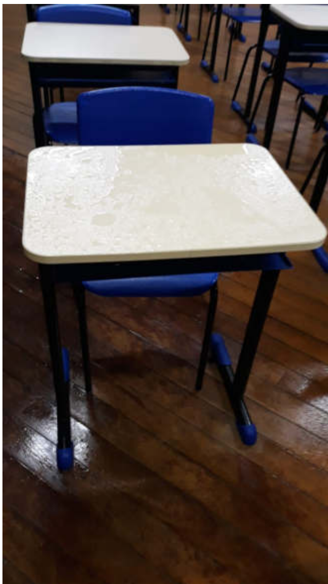
3. Goteiras em sala de aula
